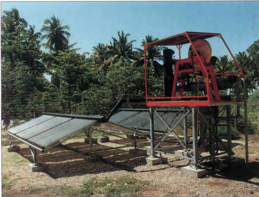
Dornier hat bisher in 18 Ländern der Dritten Welt Projekte zur Nutzung regenerativer Energien durchgeführt. Im Bild eine solarbetriebene Trinkwasserpumpe in Indonesien.
